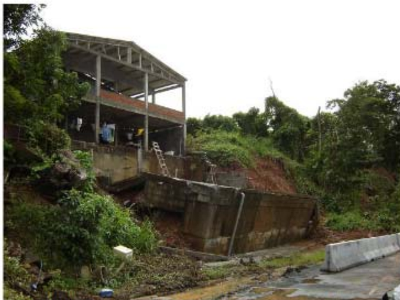
18/11/2004 – le long de la RD6, mur deversé
