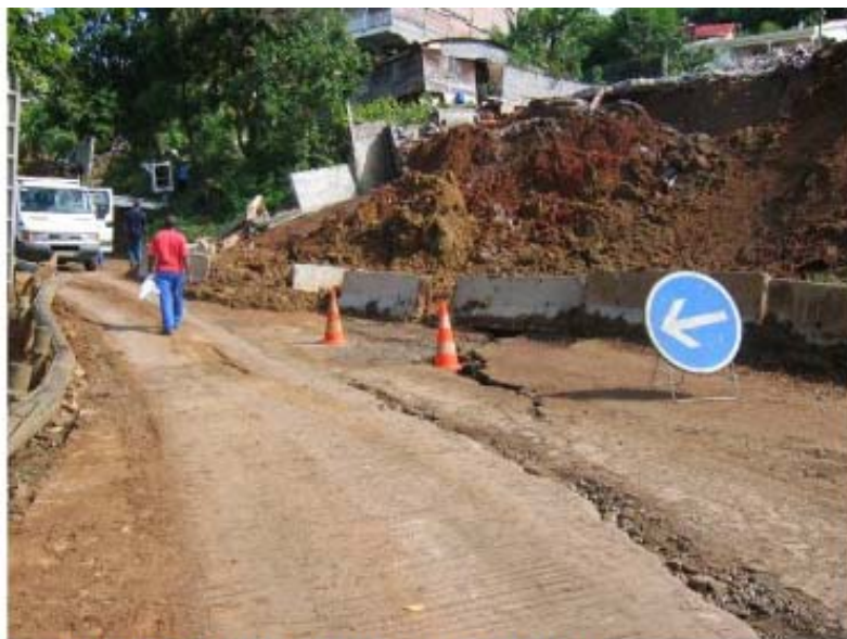
Le 27/12/2007 – Glissement de la RD6
